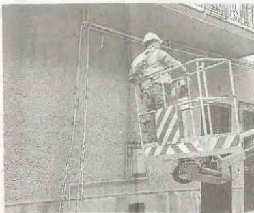
GLI INTERVENTI PER L'ILLUMINAZIONE
